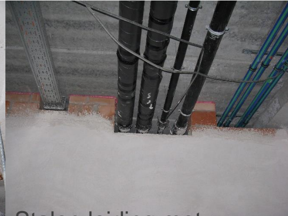
Stalen leiding met brandbare isolatie
