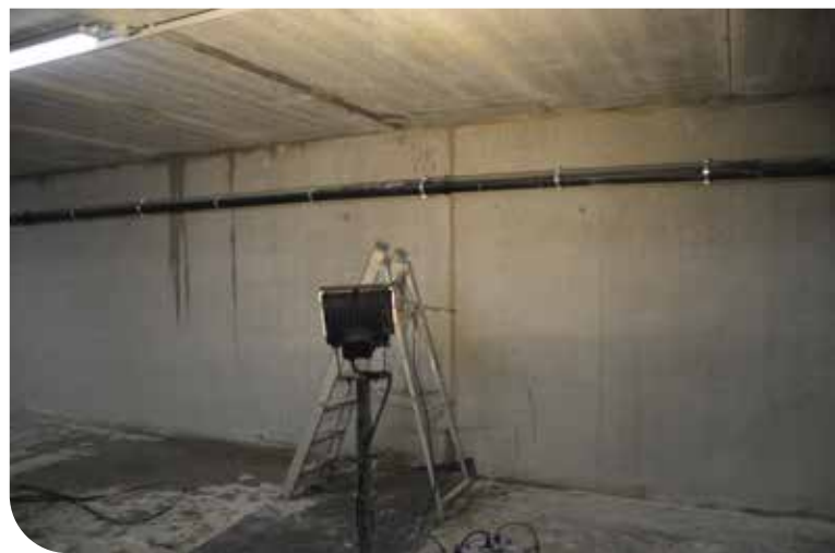
Het verschil tussen een met injectie behandelde muur (rechts) en een onbehandelde muur (links)
